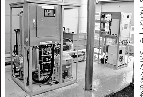
中水処理システム
